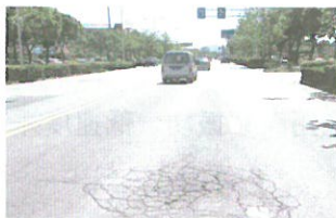
旧沥青路面裂缝
