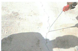
旧水泥混凝土路面裂缝
